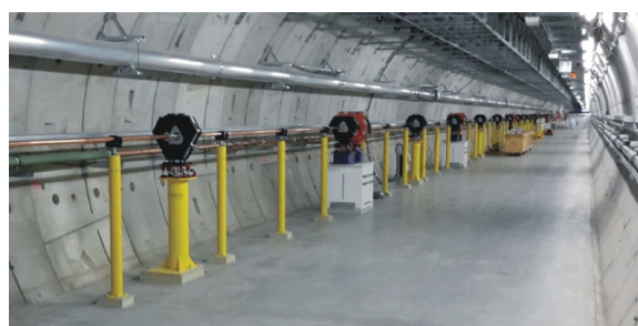
图 4 安装在 DESY 的安捷伦新型高流导离子泵(350 台)
